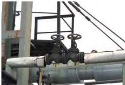
Проржавевшие и дырявые трубы будут заменены
